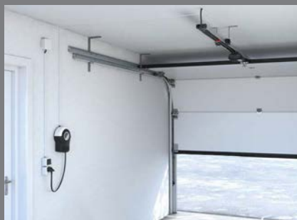
Řídicí jednotka v prostoru garáže
